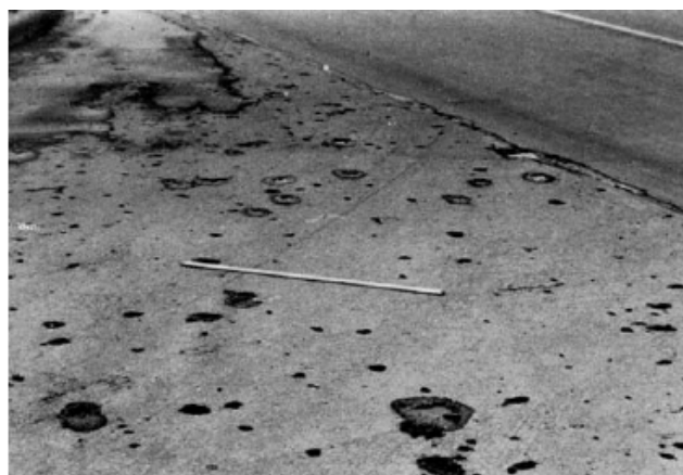
شکل ۴-۲- بیرون پریدگی در روسازی بتنی
