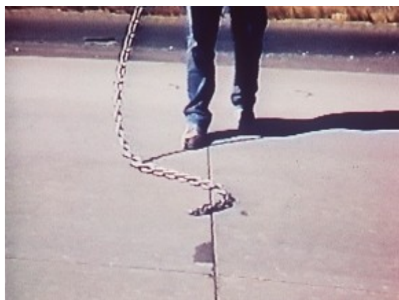
الف- استفاده از زنجیر فولادی برای تشخیص محل بتن معیوب
