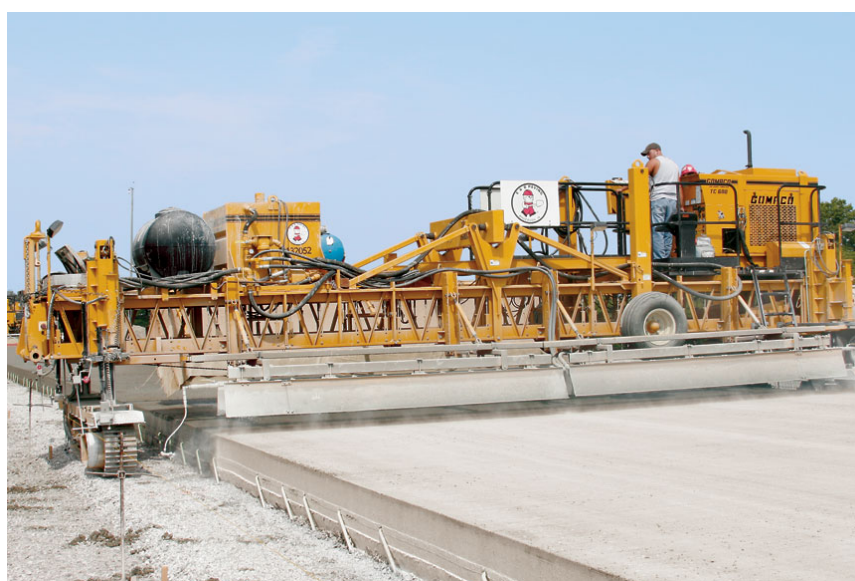
شکل ۳-۴۲- تجهیزات عمل آوری بتن
