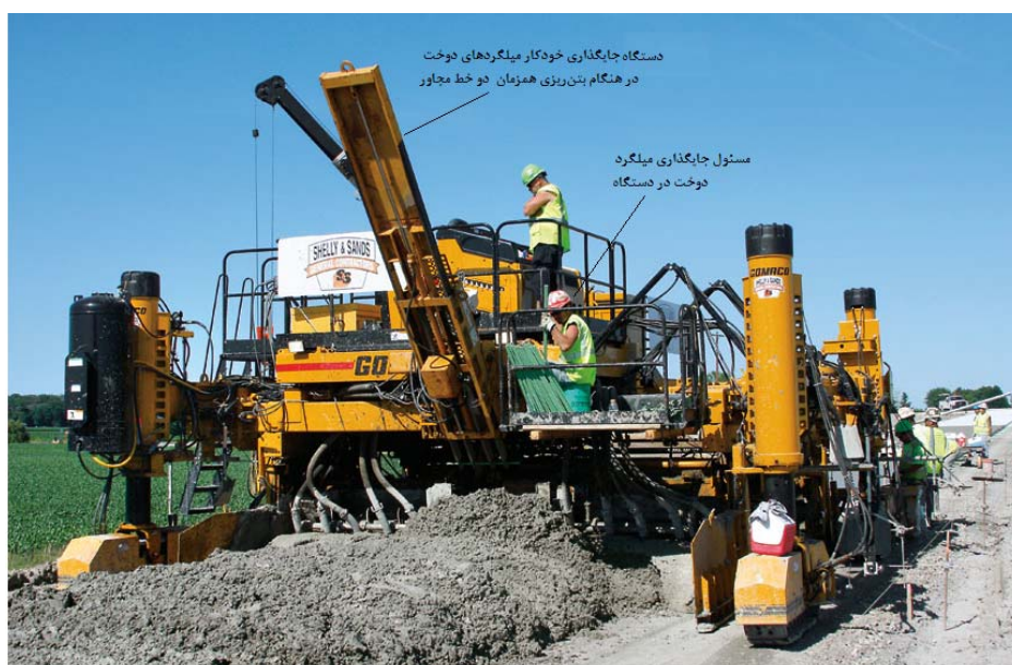
شکل ۳-۱۸- جای گذاری خودکار میلگردهای دوخت در هنگام بتن‌ریزی هم‌زمان دو خط مجاور
