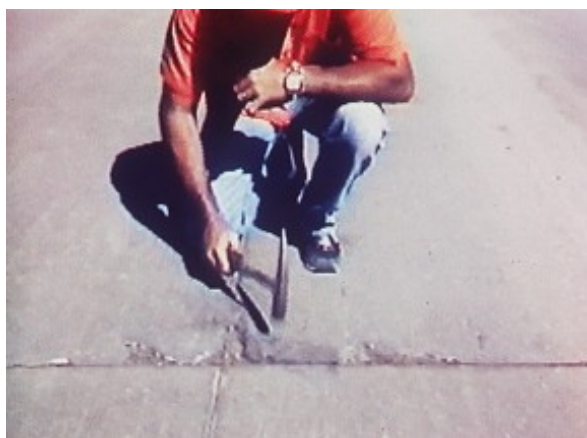
ب- استفاده از چکش برای تشخیص محل بتن معیوب
